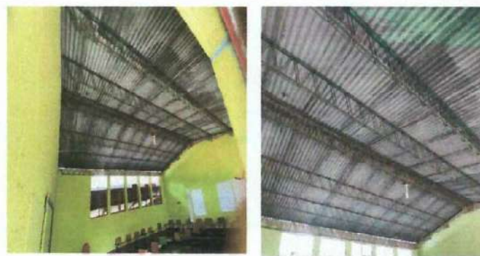
Foto 4: se necesita dar mantenimiento al sistema electrico
