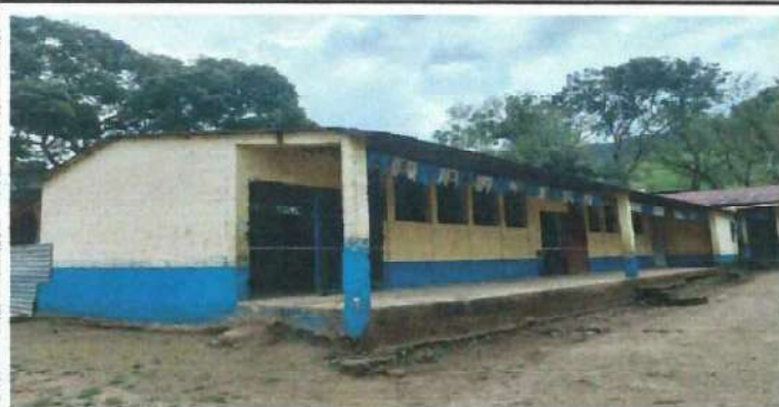
Foto 1: Se necesita cambio de cubierta de lamina
