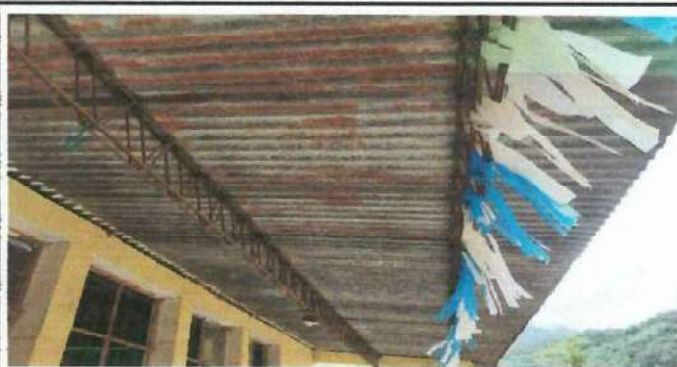
Foto 2: Se necesita dar mantenimiento a estructura de techo
